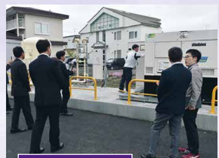
非常用発電機
