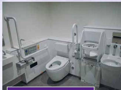
3階多目的トイレ オストメイト対応
