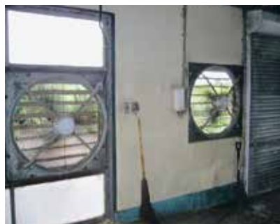
換気扇 手が届くため、稼働中に触ろうとした
