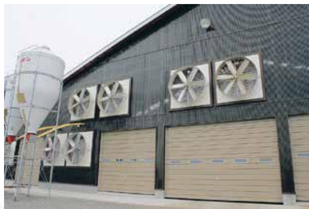
換気システム妻面
