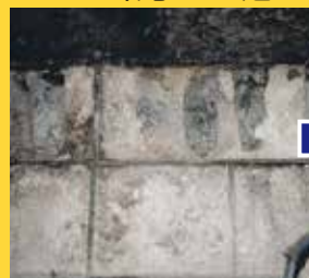
劣化したコンクリート
