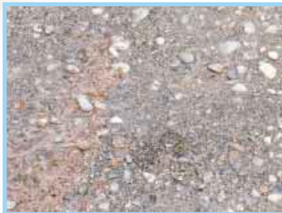
写真1 バンカー床面に小石が浮いてきている（利用5年目）
