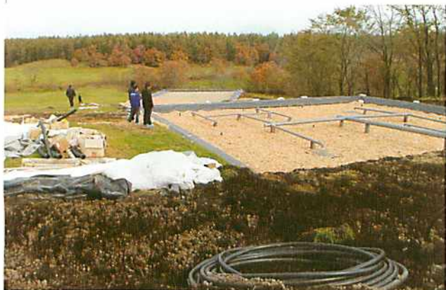
人工湿地による浄化システム
