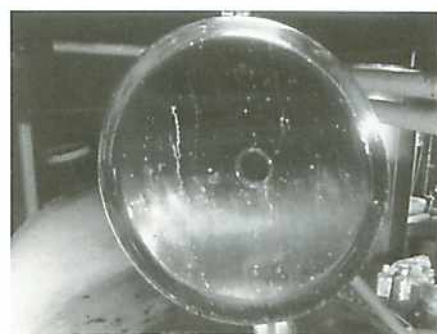
3. 投入口フタの裏側の汚れ
